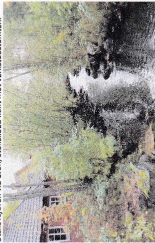
Utskovsflöden vid bron, stenskadd kant mot verkstadstomten.
